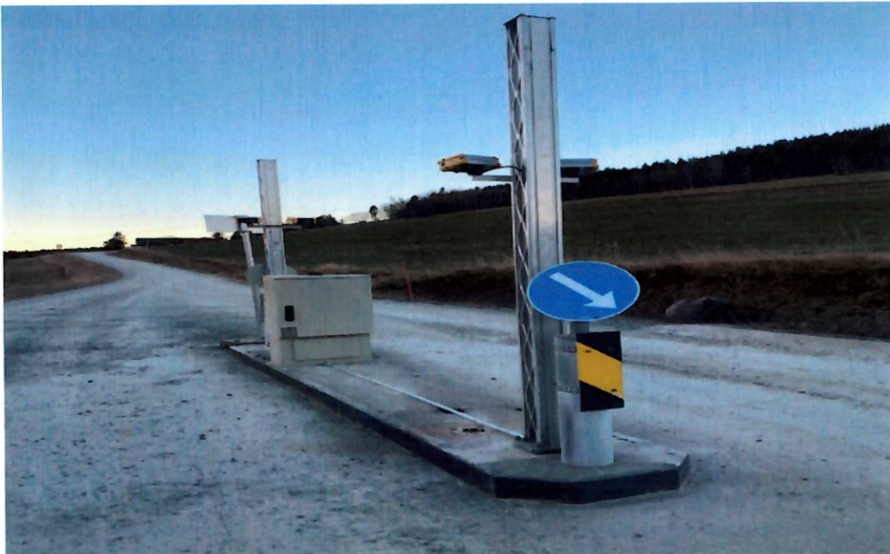
Oppgradert bomstasjon med skiltgjenkjenning
